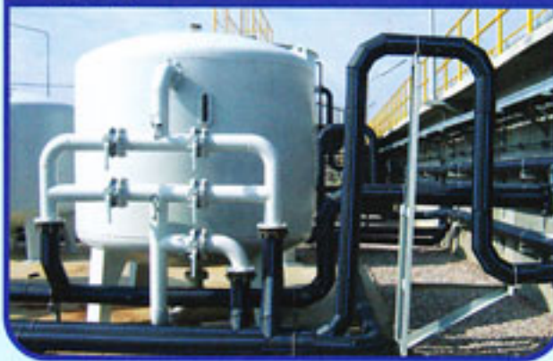
งานท่อในระบบอุตสาหกรรม (Piping system for industrial and water network)
