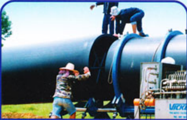
ระบบชลประทานส่งน้ำ Ø 1,600 มม. (Irrigation piping system)
