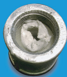
ข้อต่อเสียหาย เพราะปลายท่อเหล็กบานออก
