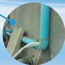
ท่อ PVC ไม่แข็งแรง กรอบแตก รั่วง่าย
